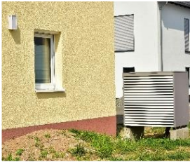
Wärmepumpe oder Wärmepumpen- Hybridheizung
