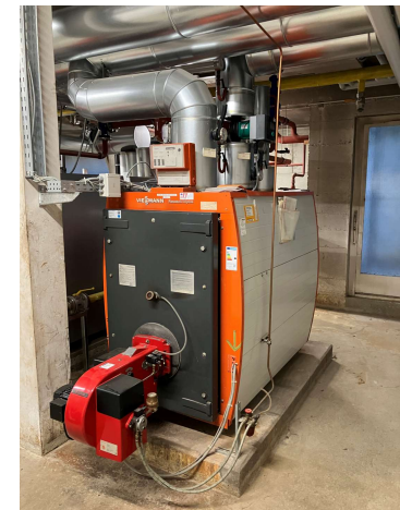
Ölheizung Schulzentrum Baujahr 1993 Leistung 400 kW
